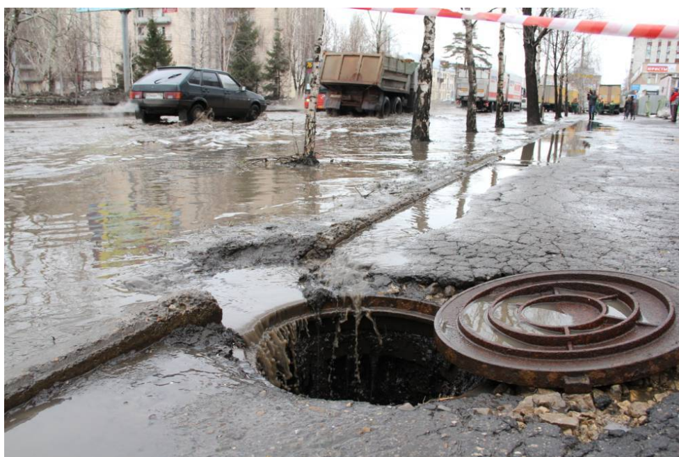
Рис. 2. Несанкционированное поступление ливневого стока с дорожной поверхности в систему хозяйственно-бытового водоотведения, в условиях отсутствия функционирующей ливневой канализации
